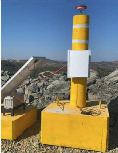
Figura 4. Estación GNSS autónoma de la mina de Riotinto.
