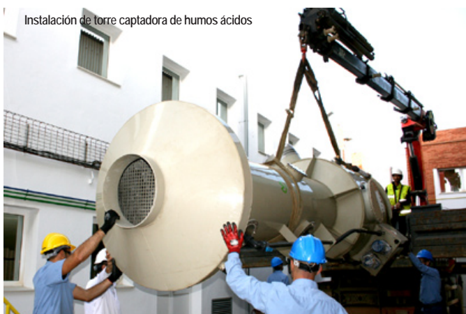
Instalación de torre captadora de humos ácidos
